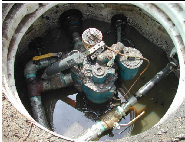
Agua y producto en el sumidero y el sensor que se movió fuera de su lugar y no puede detectar correctamente los líquidos que se encuentran en el sumidero
