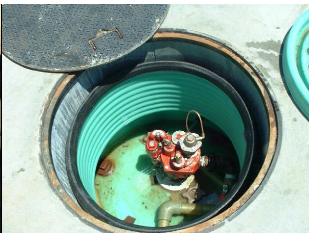
Sumidero de la BTS típico que muestra la tapa y la cubierta del sumidero
