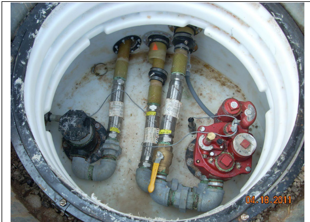
Sistema generador de emergencia presurizado equipado con un sensor intersticial.
