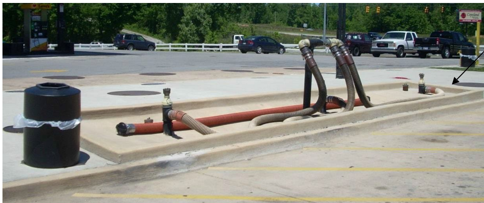
Zona de contención en el pavimento para derrames
