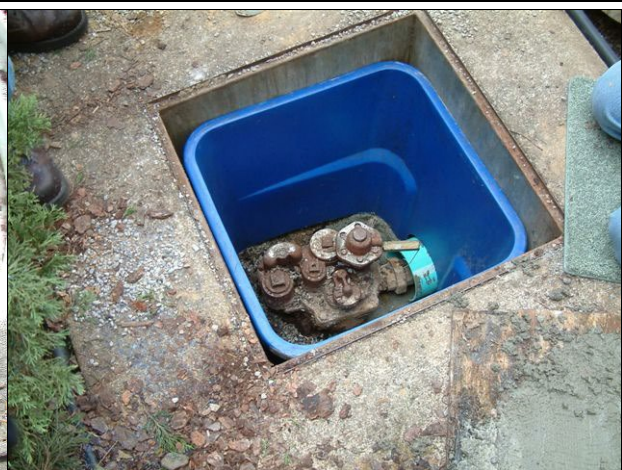
Sumidero sin contención que utiliza un contenedor de plástico para evitar que el relleno caiga sobre el cabezal de la bomba. Esto no cumpliría con los estándares de instalación actuales.
