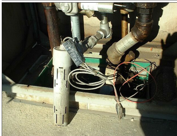
Sumidero de contención debajo del surtidor poco profundo con sensor
