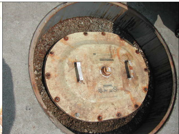
Sumidero de forma ovalada en la parte superior del tanque de plástico reforzado con fibra de vidrio (FRP)
