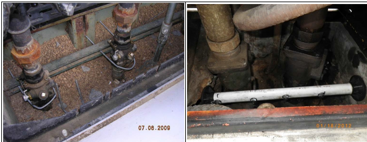
Arriba se muestran ejemplos de válvulas de corte ancladas de forma incorrecta:
