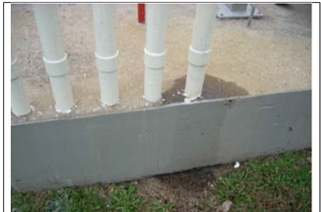
Un tanque sobrellenado puede provocar una fuga por el tubo de ventilación
