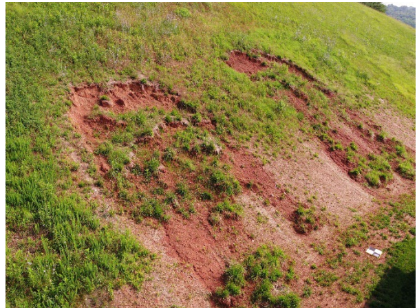
(d) Aerial image of the slope failure
